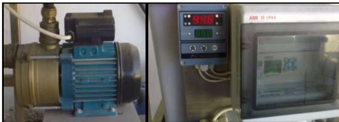
Εικόνα 3 Ηλεκτρικός Πίνακας Αυτοματισμού και Αντλία
